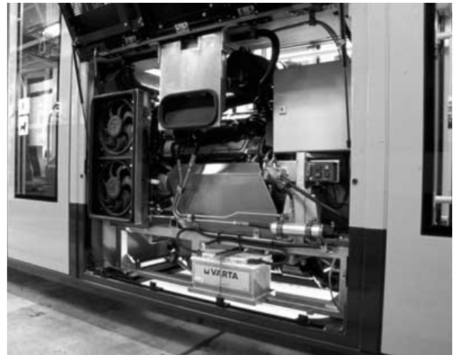
Blick auf das Dieselaggregat bei geöffneter Außenklappe
