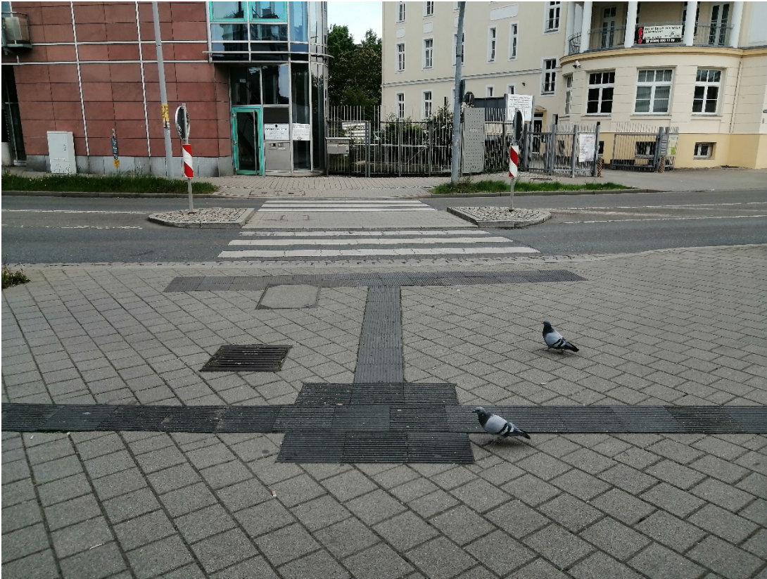
Foto 9: Auf der Südostseite des Fußgängerüberwegs über die Bahnhofstraße (gegenüberliegende Seite) fehlen taktile Elemente.
